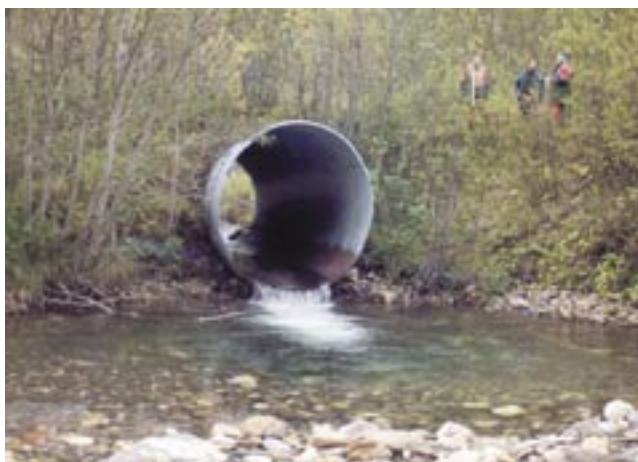
Dårlig kulvertløsning ved kryssing av bekk, erosjon nedstrøms, røret ikke kappet/tilpasset veifyllingen og vannstandssprang kan hindre oppgang av fisk. .
