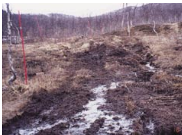
Bildet viser en utrast veiskråning blant annet på grunn av manglende vegetasjon som kunne bundet eller armert massene
