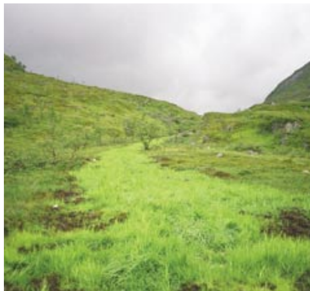
Bildet viser begynnende erosjon og utglidning i og på siden av anleggsvei. Det er behov for vegetasjonsetablering for å armere jorda og stanse de negative prosessene. Lysbotn kraftverk, Senja. Foto: Bjørn Rasch Tellefsen
