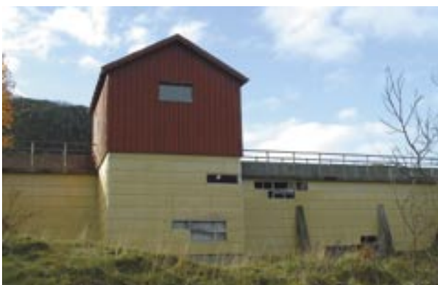
Platedam i betong med isolervegg kledd med eternitt. Dette må karakteriseres som uheldig valg av materialer og farge
