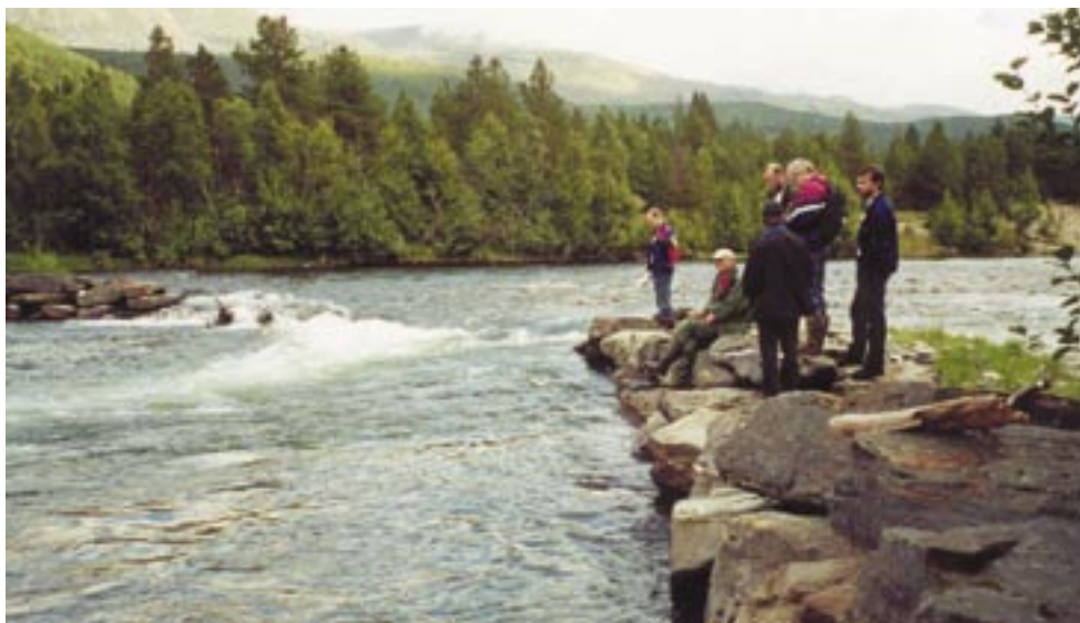
Syvdeterskel i Skibotnelva delvis sammenrast i senter i hovedsak på grunn av dårlige grunnforhold.
