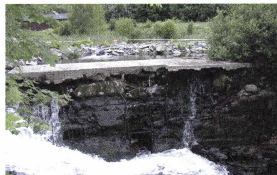
Dårlig stand: Det var ingen tvil om at dammen trengte rehabilitering.
