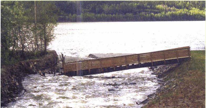
Prosjekt uten nødvendig sikring: Vannføringen i flere sidevassdrag til Gudbrandsdalslågen var pinseaften den største siden flommen i 1995. Bildet er tatt etter at flommen er gått tilbake. Gangbrua er oppført av private interesser uten nødvendig sikring. Foto: Roar Øvre.
