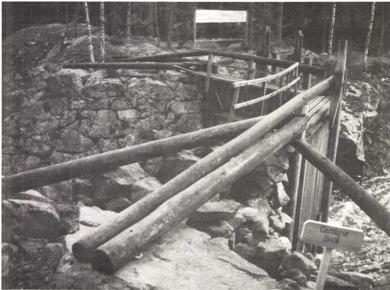
Sluseporten "Caroline Soot" har vært restaurert, men er i ferd med å falle sammen på grunn av manglende tilsyn. (Foto: Lars Tore Martinsen, 1990)
