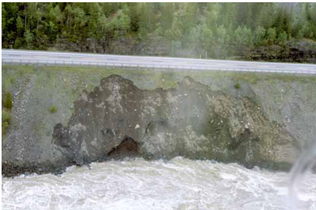
Fig 3.1. Erosjon. Lågen ved E6 nedstrøms Hunderfossen 1995. Foto Hallvard Berg, NVE.
