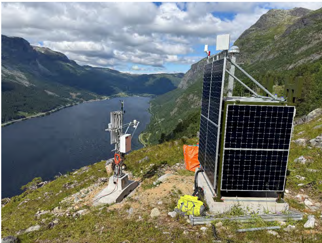
Figur 20: Strømforsyningsbrakka på «plataet» med batteribank og utstyr for lokal strømforsyning til overvåkingsanlegget. Værstasjonen er montert ved siden av brakka. Foto: P. Røssevold / NVE.
