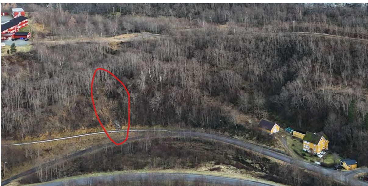
Figur 12: Den nyeste utglidningen i terrasseskråningen nord for Tredalsbotnen markert med rødt.
