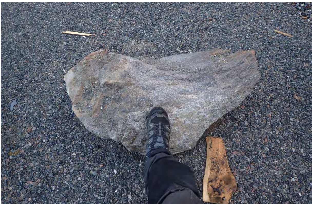
Figur 14: Blokka som skadet tak på Tredalsbotnen 3.
