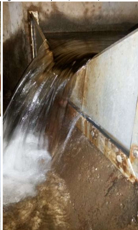
Figur 8-119: V-Profil og en liten lekkasje (Foto: NVE)
