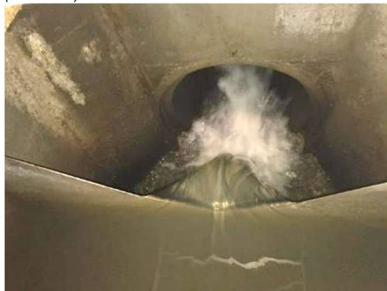
Figur 8-106: V-profil og utløp overvannsrenne (Foto: NVE)
