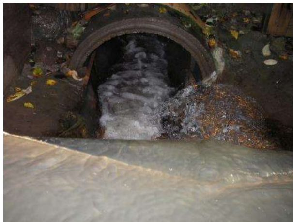
Figur 8-5: Utløpsrør (Foto: NVE)
