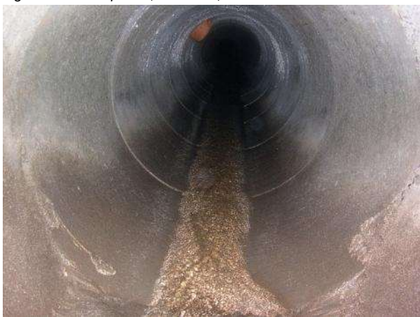
Figur 8-93: Utløpsrør (Foto: NVE)
