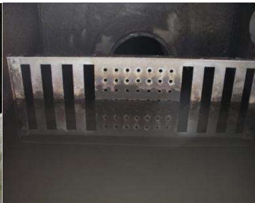
Figur 8-37: Hastighetsdemper og innløpsrør (Foto: NVE)
