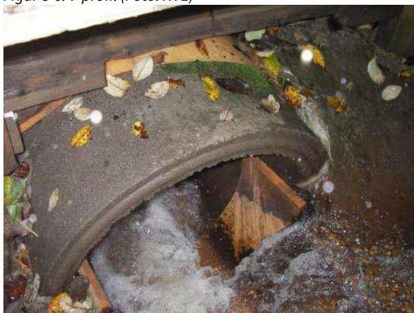
Figur 8-8: Utløpsrør (Foto: NVE)
