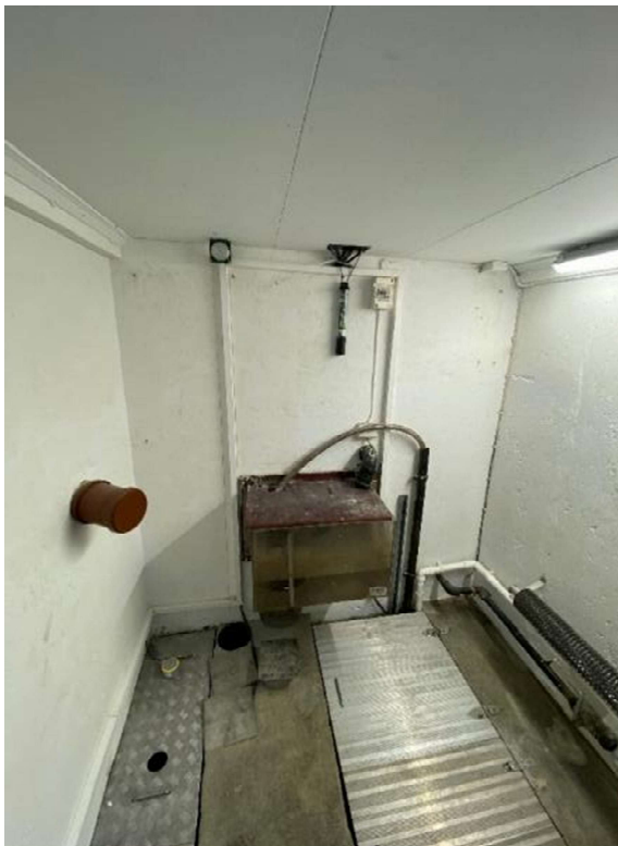
Figur 8-104: Risvolla målestasjon underetasje (Foto: NVE)
