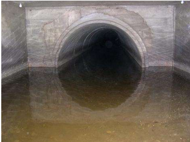
Figur 8-91: Innløpsrør (Foto: NVE)
