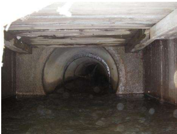
Figur 8-4: Tilløpsrør (Foto: NVE)
