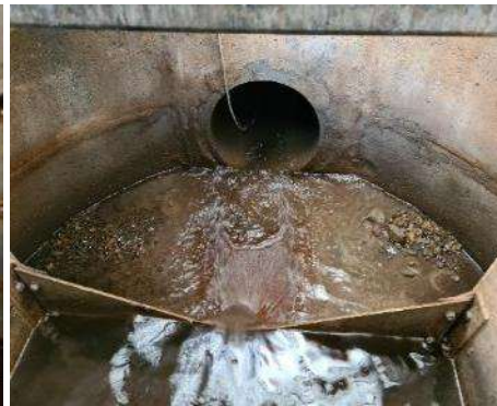
Figur 8-117: Utløpsrør (Foto: NVE)
