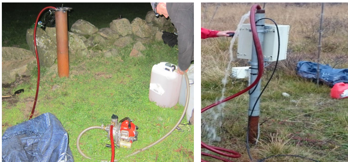
Figur 4.1.1: Viser eksempel på pumpesystem. Det brukes enten elektrisk eller bensindrevet pumpe. Egnert slange presses ned til bunn av rør. Når vann presses ned med høyt trykk vil sedimenter dyttes til overflaten og ut av røret, samt ut til grunnen via slisser i filterspissen på røret. Foto: NVE.
