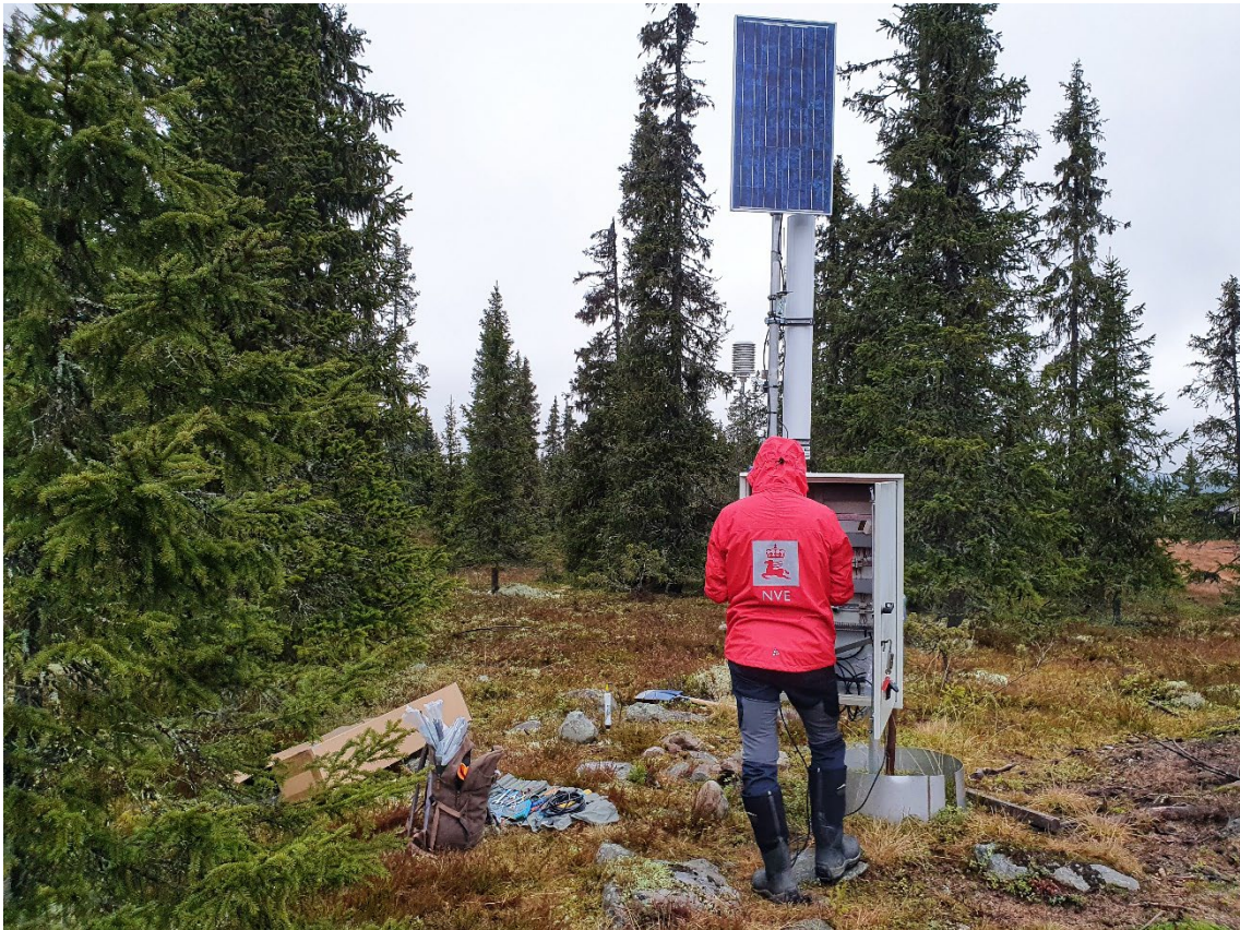
Figur 5.2.2.1 Installasjon av nytt CRS- instrument på målestasjon 2.715.2 Kvarstadsæter, 25. oktober 2021. Instrumentet er det vertikalstilte hvite røret under solcellepanelet. Foto: NVE.
