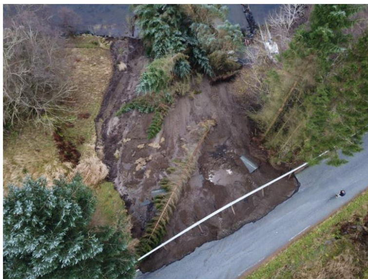
Halve vegbana på ei strekke på kring 50 meter har rast ut. Foto: Gulen brannvesen
