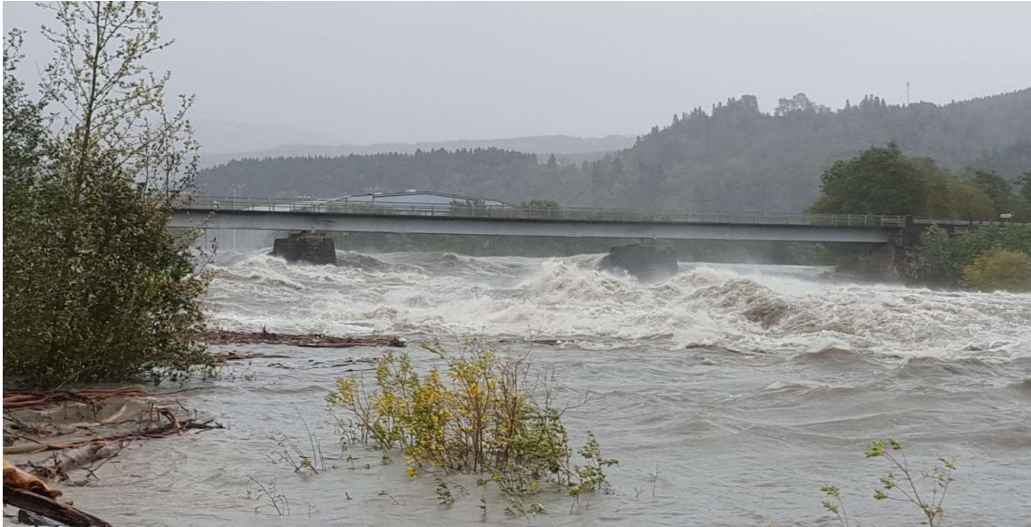
Figur 3-5: Bilde av Østnesbrua tatt under flommen 2. oktober 2015. Bilde: Kjartan Orvedal, NVE.
