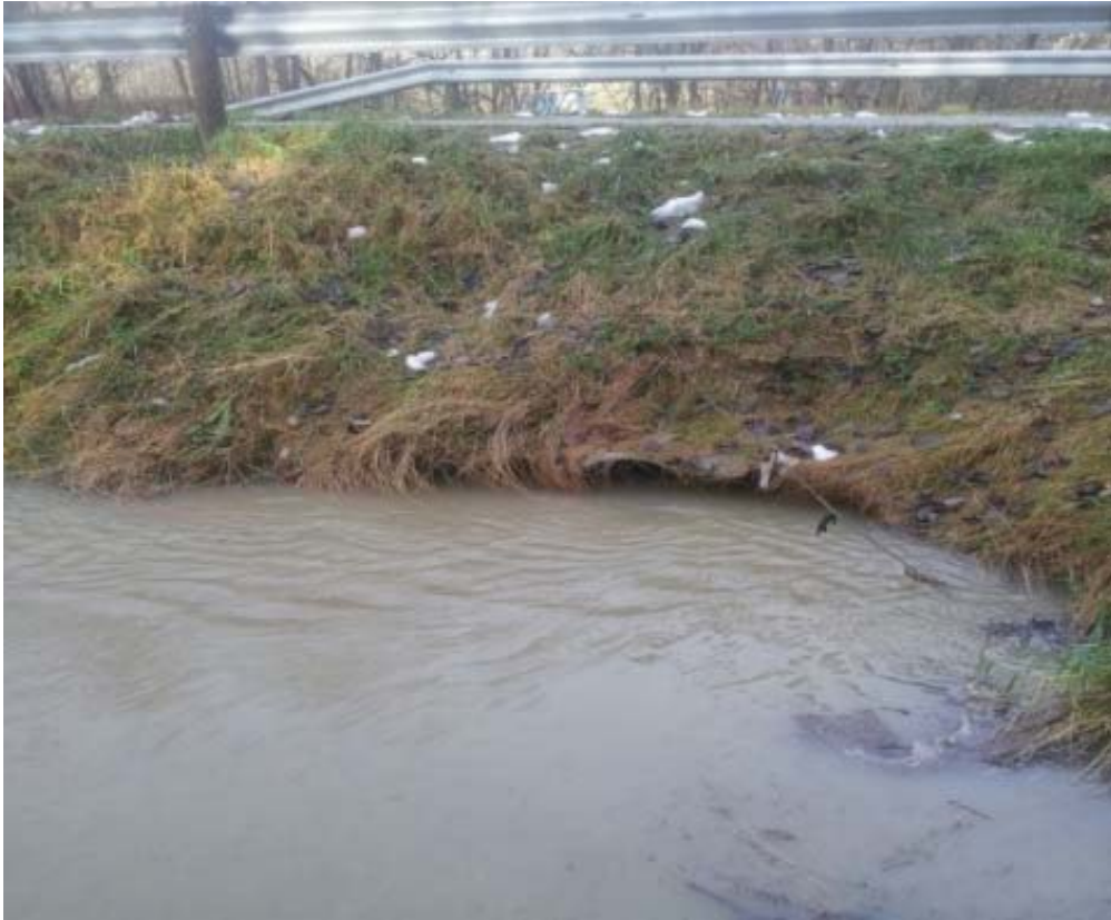
Figur 3-15 Profil 151: Utløp av kulvert under Godheimveien. Vannstanden under flommen i 2012 var 104,0. (Foto: NVE, 02.11.2012)
