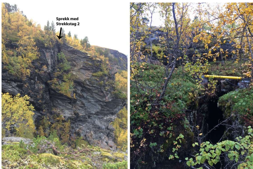
Figur 16 Bilder av sprekken og strekkstag 2, hvor vi måler mest bevegelse.
