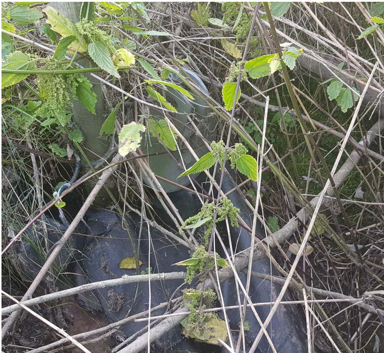
Figur 7- Ø200 lavvannsrør med tilbakeslagsventil gjennom flomverket (Bilde: Multiconsult)
