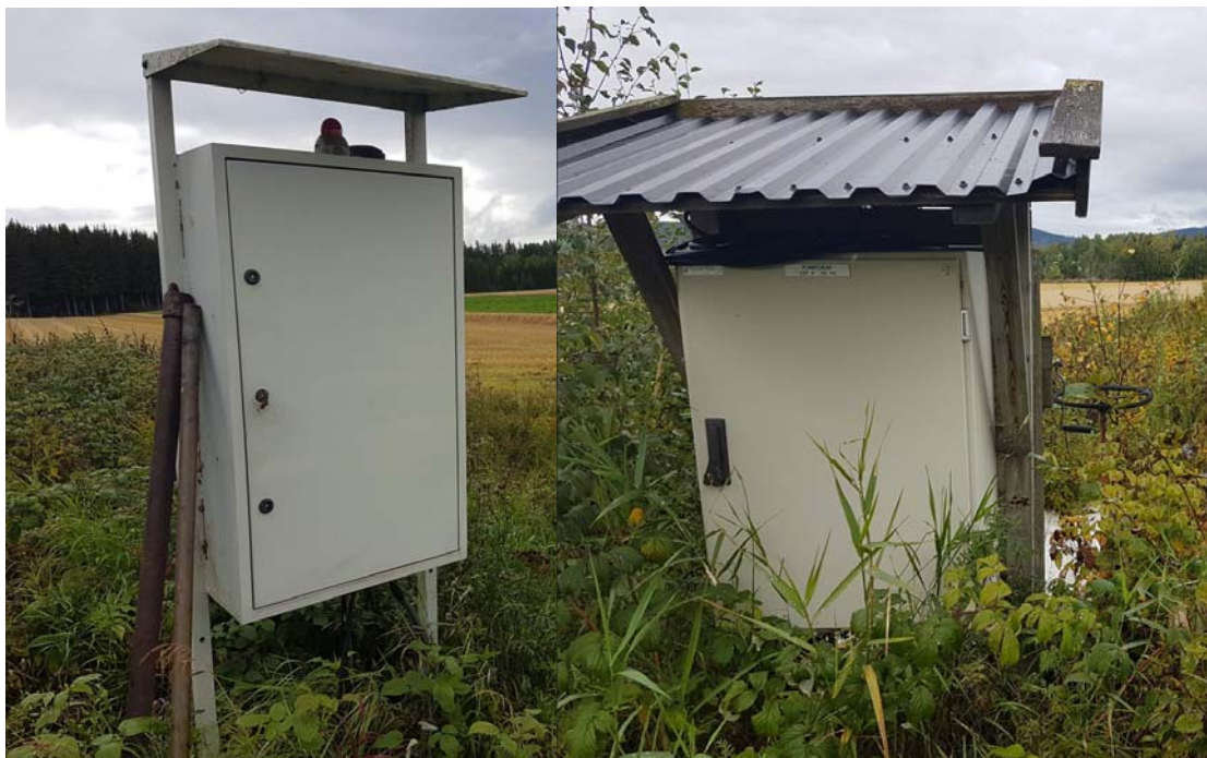
Figur 10 – Pumpestasjonene ved flomverket (Bilde: Multiconsult)
