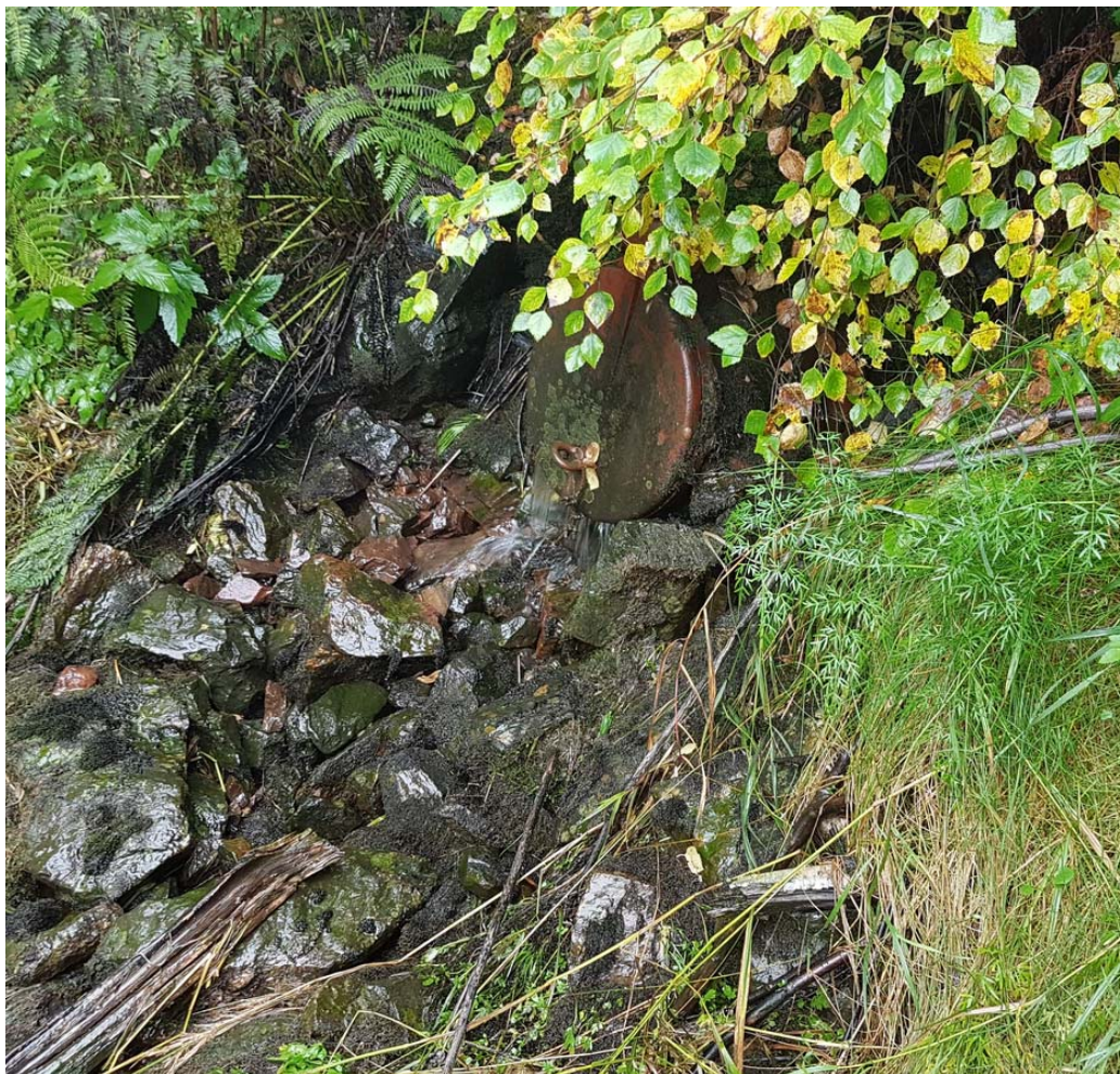
Figur 9 – Tilbakeslagsventil ved Ø400 lavvannrør (Bilde Multiconsult)
