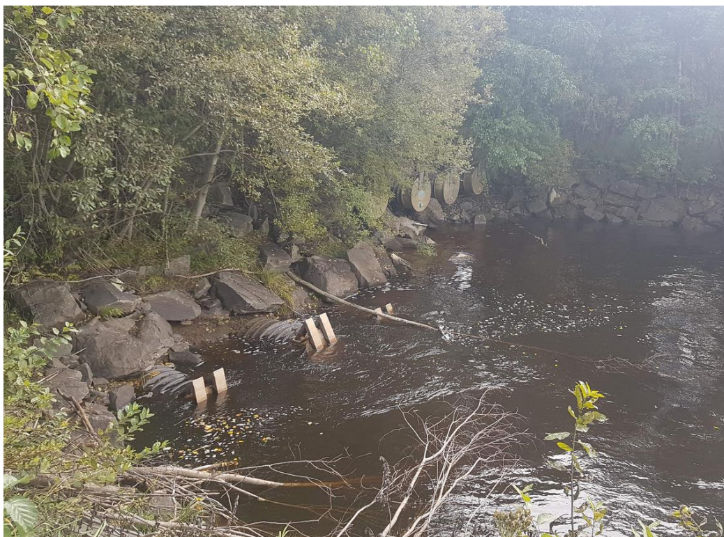
Figur 11 – Ventiler og lavvannrør ved Roverud pumpestasjon (Bilde: Multiconsult)
