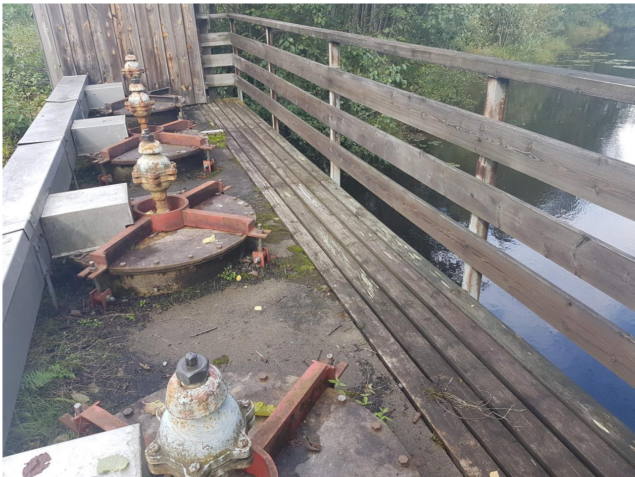
Figur 13 – Roverud pumpestasjon (Bilde: Multiconsult)
