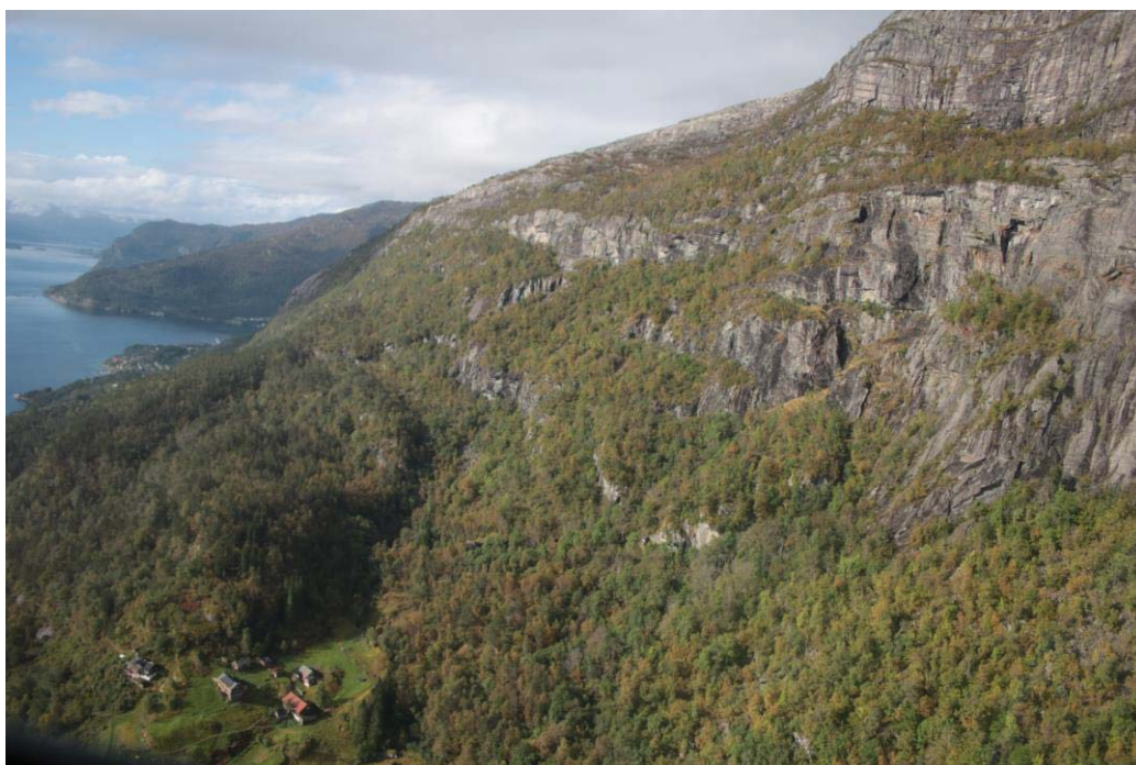
Bilde 28. Bratte bergskråninger ved kartleggingsområdet Kjepso, der det er observert flere potensielle utløsningsområder for steinsprang. Bildet er tatt mot sørvest.
