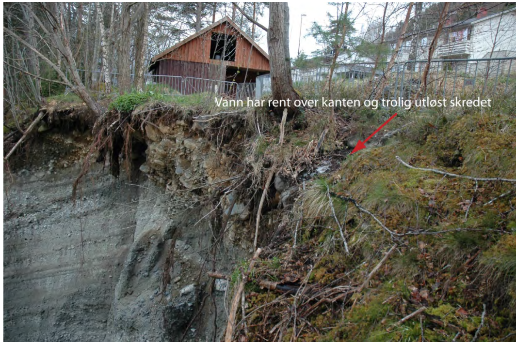
Fig. 4.5.3.2. Spor etter vann som har drenert over kanten av terrasseflata og trolig utløst skredet i 2011.
