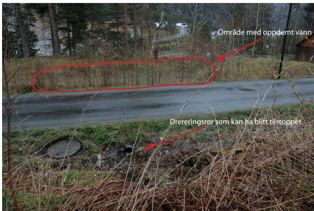
Fig. 4.5.3.1. Terrasseflata over skredet som gikk i 2011. Det er klare spor etter vann som har samlet seg på overflata.
