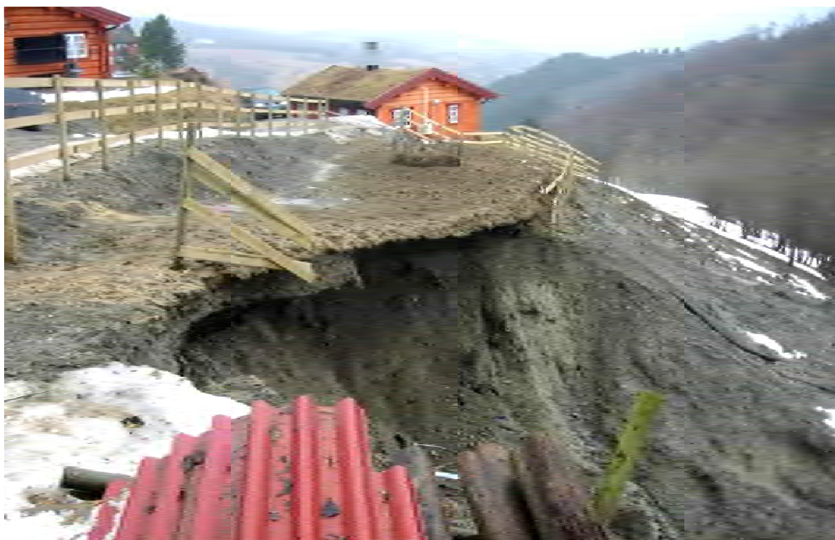
Fig. 4. Poretrykk/bekkeerosjonsutløst jordskred. Buan, Kvåle, Orkdal. 26.03.2012. Foto: Joar Skauge.
