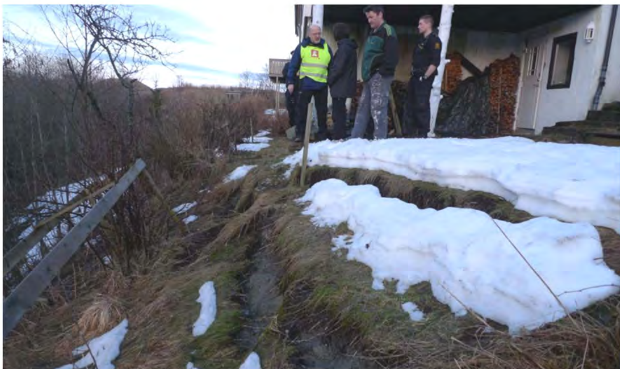
Fig. 3. Egganveien 48, Sjetnemarka, Trondheim. Sprekk i skråning som skyldes vannmetning i tilførte masser. "hageutglidning". Leire i grunnen. Foto: Terje H. Bargel.
