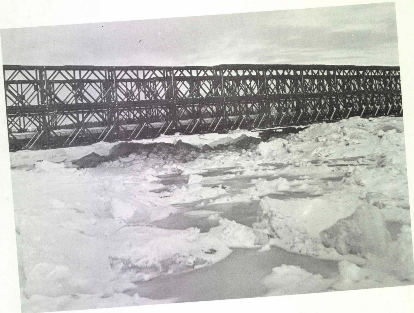
Isansamling ved brua. Isflakenes tykkelse 60 cm
