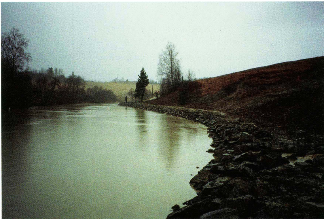
Figur 23: Erosjonssikring i foten av høy leirskråning. Rakkestadelva, Østfold
