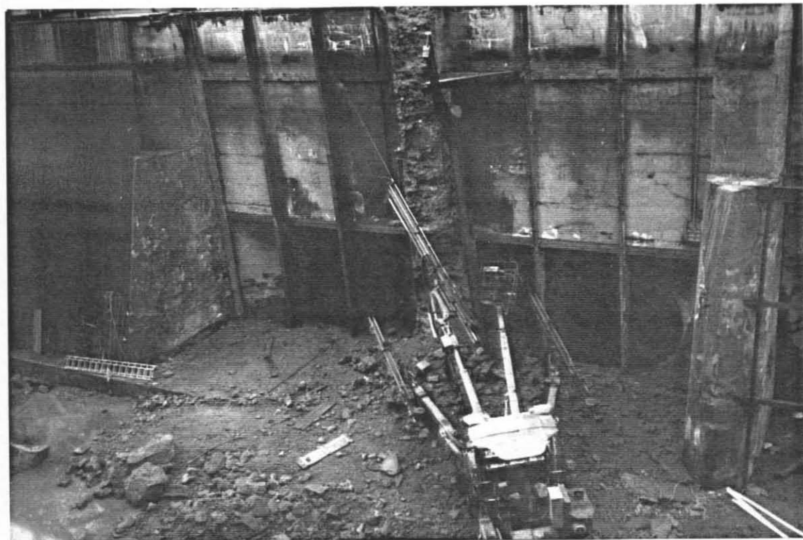
Nedhugging av gammel inntakskonstruksjon
