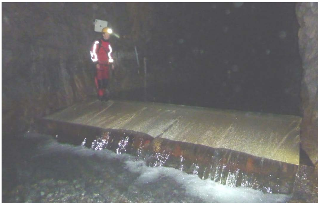
Fig. 1.9 Crump-overløp i Fonndalstunnelen, april 2013. Vannstand 0,025.
