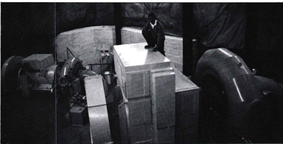
Maskinmester Thato er den eneste igjen av de som ble opplært til å drive Mantsonyane kraftstasjon. Hans problem for tiden er mangel på avløsningsmuligheter.
