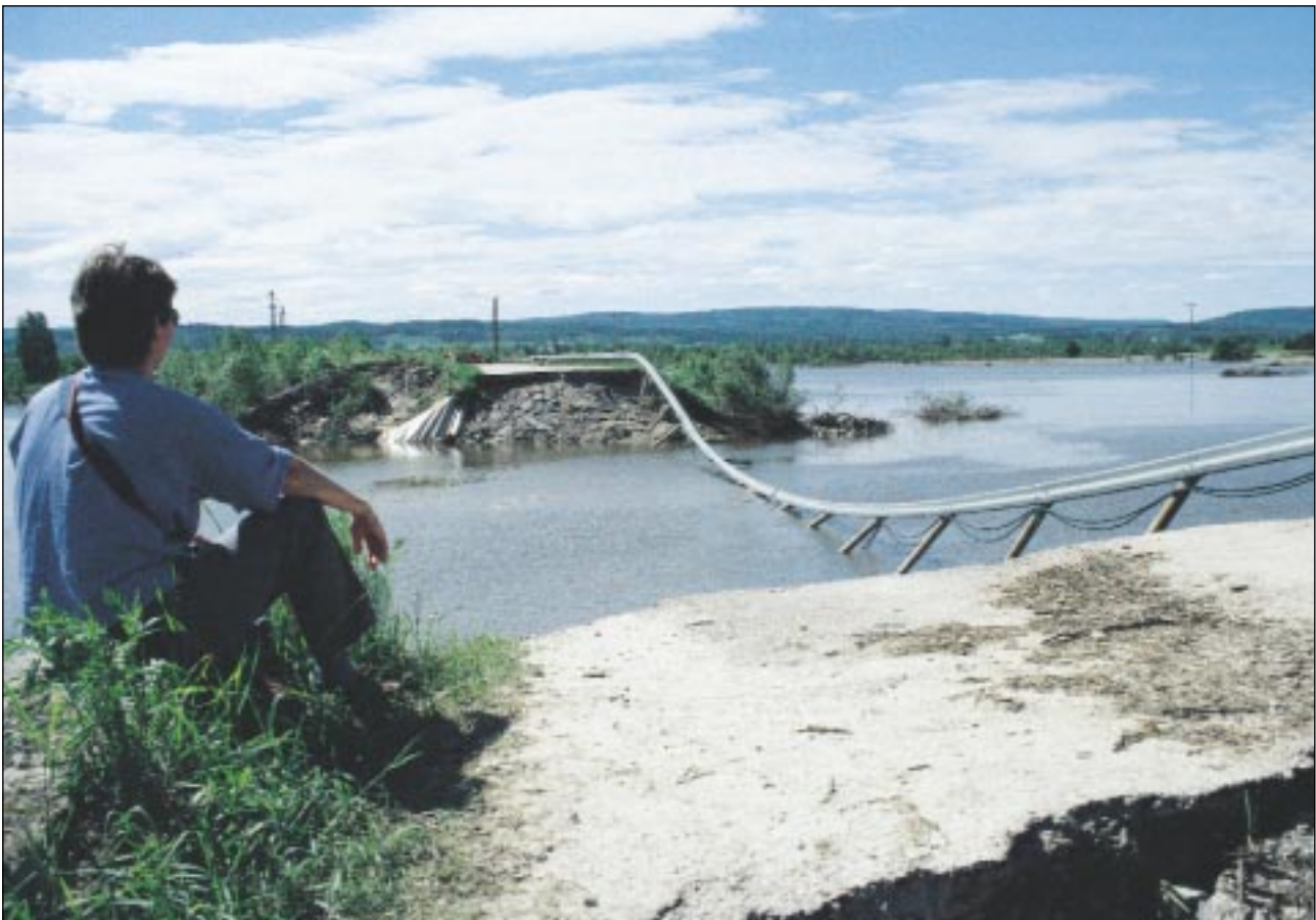
Figur 1.10 Flomskadet vei. (Foto: Per Einar Faugli)
