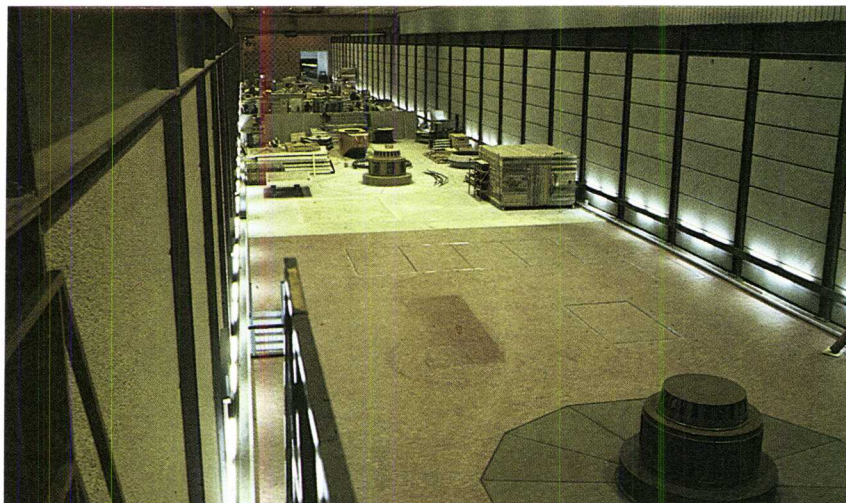
Sima kraftstasjon, oktober 1980.
