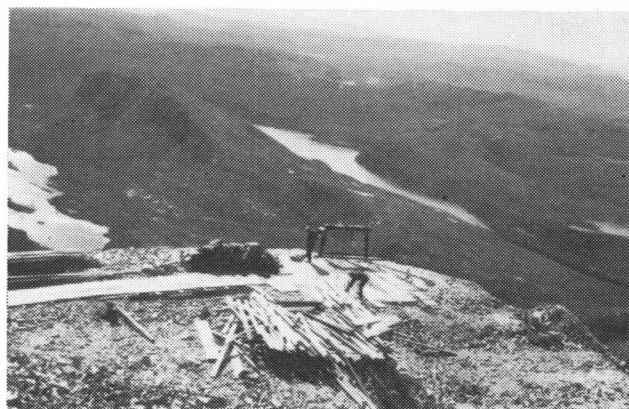
Antennehus, Lynås foretar «sammenkoplingen» med NVE-bygg.
