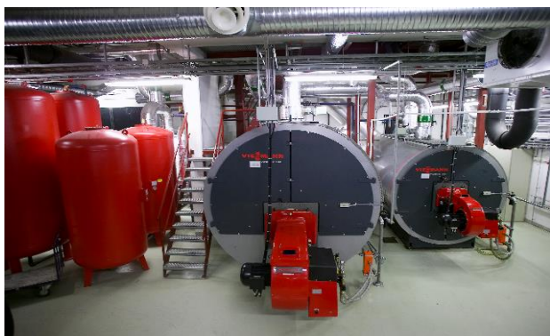
Figur 2 Oljefyringsanlegg i yrkesbygg
