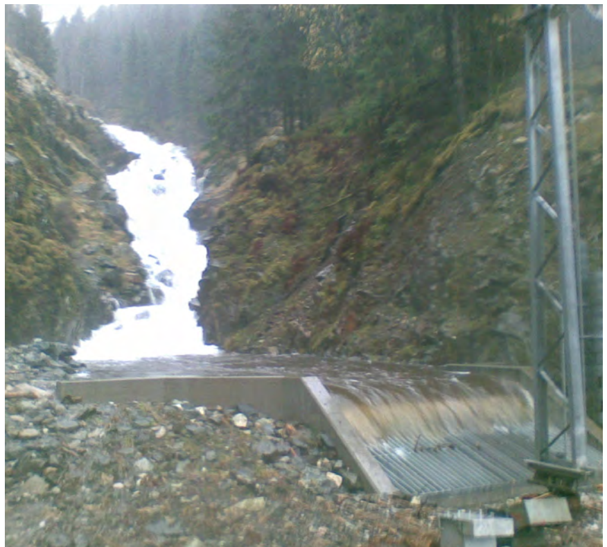
Bekkeinntak ved Langhelle med flomvannføring. Foto: John endre Fossmark.
