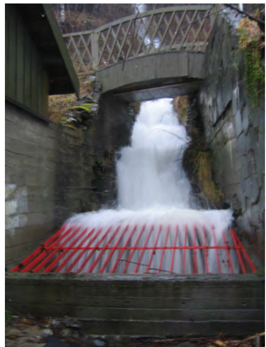
Bekkeinntak med selvrensensende rister, i flomsituasjon, foto Ole Erik Almenningen.
