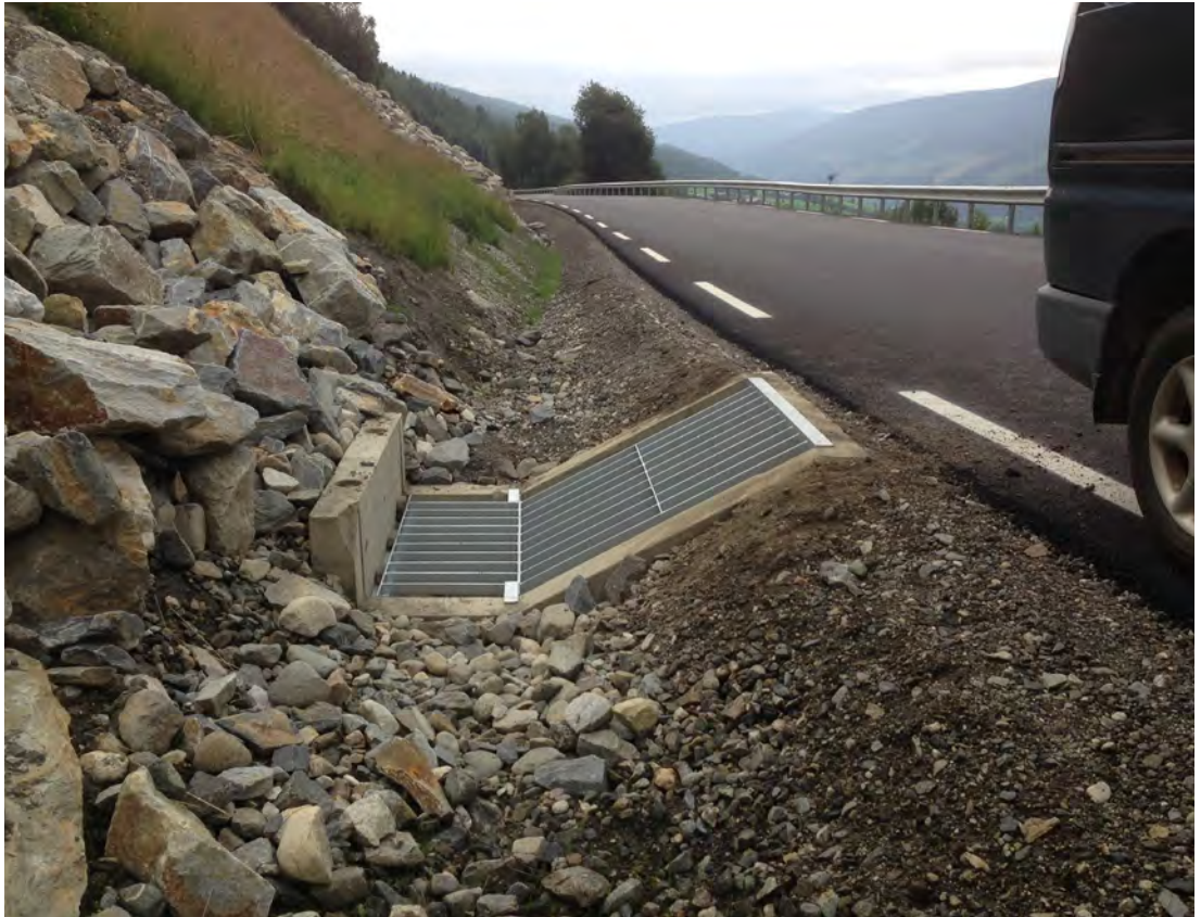
Viser hvordan inntaket er tilpasset grøfteprofilen (foto: Per Arne Kolseth).
