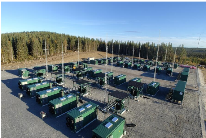
Bilde 2. Isbillen Power Reserve ble satt i drift våren 2025 i Ångermanland i Sverige. Anlegget er Nordens største enkeltstående batteriløsning, med en effekt- og lagringskapasitet på 94 MW / 94 MWh. Foto: Neoen
