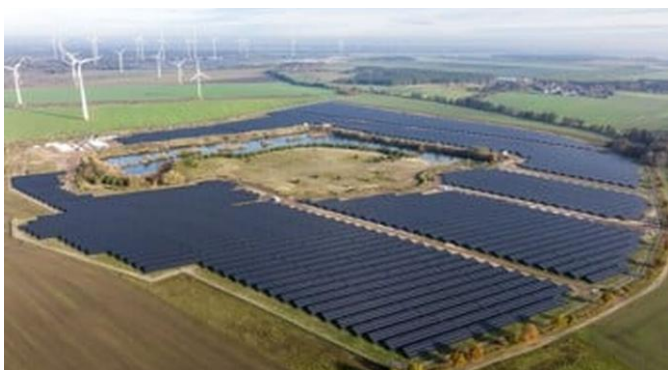
Bilde 3. Tysklands største hybride sol- og batterianlegg Zerbst ble satt i drift høsten 2025 i Sachsen-Anhalt. Anlegget består av et 46 MW solkraftverk, og et 16 MW batterianlegg med 57 MWh lagringskapasitet. Foto: Statkraft
