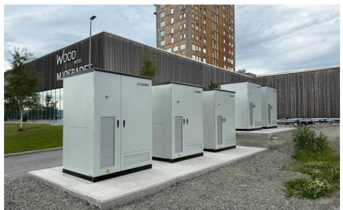
Bilde 2. Et 1 MW batterianlegg ved Mjøstårnet i Brumunddal. Anlegget er installert sammen med solceller og lynladere, og skal blant annet bidra til å bedre samspillet mellom lokal solkraftproduksjon, lagring og forbruk. Foto: Suniqon
