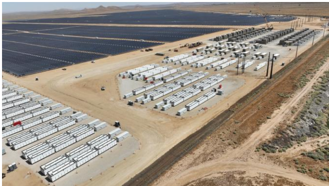
Bilde 1: Verdens største integrerte sol- og batterianlegg Edwards Sanborn ble satt i drift i 2023 i California. Prosjektet består av et 875 MW solkraftanlegg og et batterilagringsystem med over 3 GWh lagringskapasitet. Foto: Mortenson / Terra-Gen, LLC
