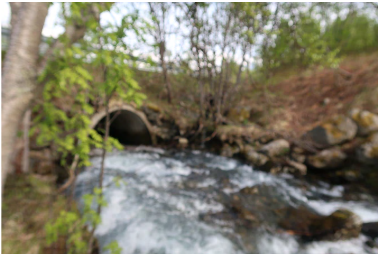
Foto 5.6. Kulvert der Golpeelva krysser Hamnebuktveien. Kulverten har solid dimensjon (d: 2400 mm) men det antas at flom- eller skredmasser er avsatt i kulverten og reduserer kapasiteten. Bildet er ikke i fokus.
