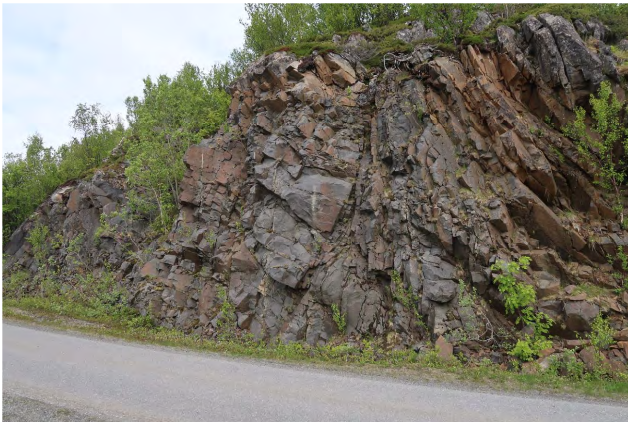
Foto 3.15. Rottoberget nord for Jøkelfjordeidet er vurdert som en overgang mellom sprengt skjæring og naturlig bergskrent. Løsnestanssynligheten er vurdert som > 1/100 .
