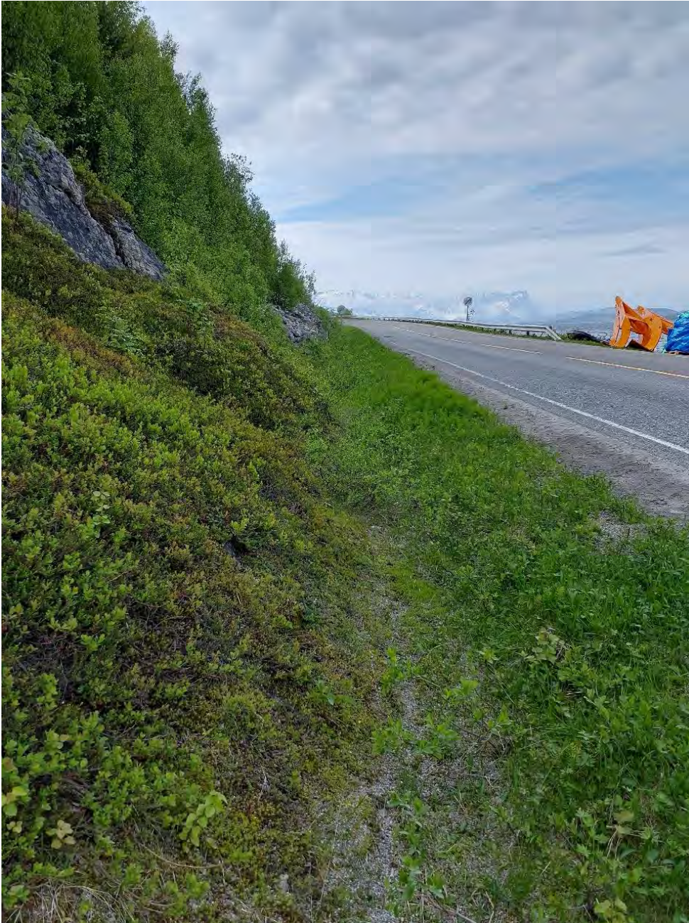
Foto 9.19. Utløpsområde for steinsprang ned på vei i sørvestlig del av kartleggingsområdet.
