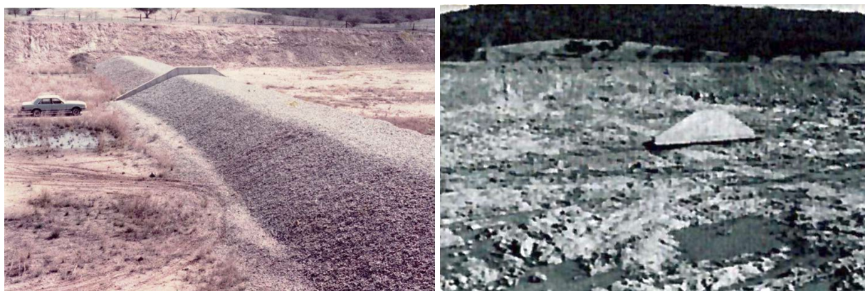
Figur B 29 Eroderbare flomløpet med to sikringsdammer ved Mnjoli dam a) Før aktivering i 1985 (bilde fra Sheerman-Chase i (Hinks & Goff, 2018)) b) etter flomhendelsen og bruk av eroderbare flomløpet. Betong veggen mellom de to seksjonene står fortsatt. (Bilder fra (Engels, E.T.; Sheerman-Chase, 1985))
