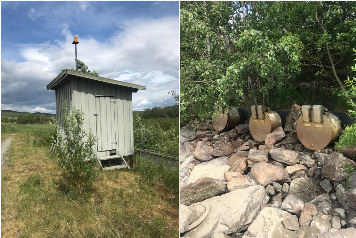
Figur 12: Teknisk hus ved pumpestasjonen (hus for pumper kan skimtes nede til høyre) og utløpsventiler fra pumperørene på vannsiden av flomverket (Bilder: Multiconsult).
