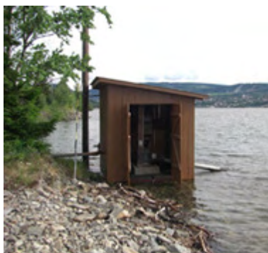
Pumpehus ved Vingrom 11. juni.
