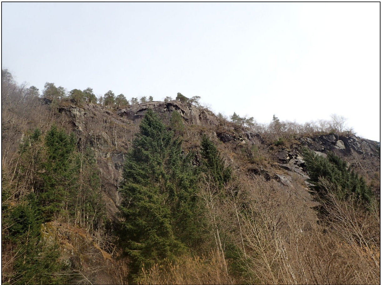
Figur 6 Losneområde steinsprang over Modalsvegen 1546.
