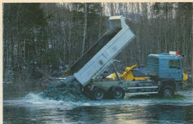
Stjørdalselva får ny bunn. Steinmasser planeres ut i elven og det hele avsluttes med store fyllinger på siden som vender mot kvikkleiren.
