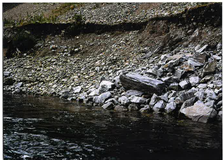
Bilde 5: Bunnsenkning. Dette er et flom- og erosjonssikringsanlegg som nå er helt ødelagt på grunn av store flommer og undergraving fra bunnerosjon. Bunnsenkningen ved dette anlegget i Altaelva var mellom åtte og ti meter!
