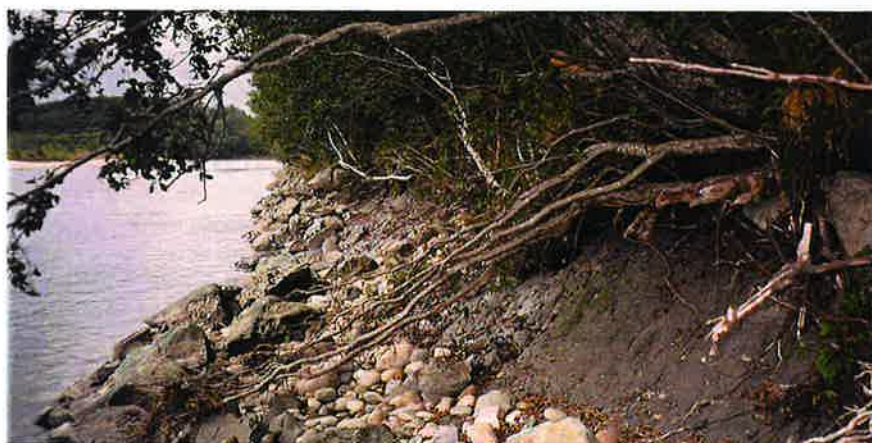
Bilde nr 6: Blottlagt leire. Dette er en erosjonssikring i Gaula. Her er deler av sikringen borte slik at leiren er blottlagt. Ved neste flom vil mer masser vaskes ut.
