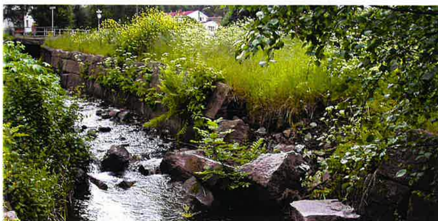
Bilde 8: Skadet tørrmur. I denne tørrmuren har enkelte steiner flyttet seg og i tillegg har et stykke rast ut under flom. Resultatet er en åpen skrent der det kan erodere inn til veien ved neste flom. Skådalsbekken går gjennom tett bebygd område i Oslo.
