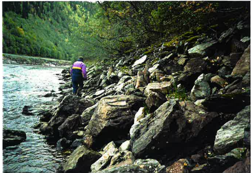
Bilde 1: Utrasing av erosjonssikring. Bildet er fra Gaula. Her er erosjonssikringen undergravet. Sikringen ser uryddig ut og steinene har beveget seg nedover skråningen.
