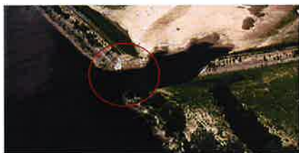
Bilde 2: Brudd på flomverk. Her er det brudd på flomverket langs Glomma ved Stemsand. Årsaken er trolig grunnbrudd som følge av undergraving og utvasking.
