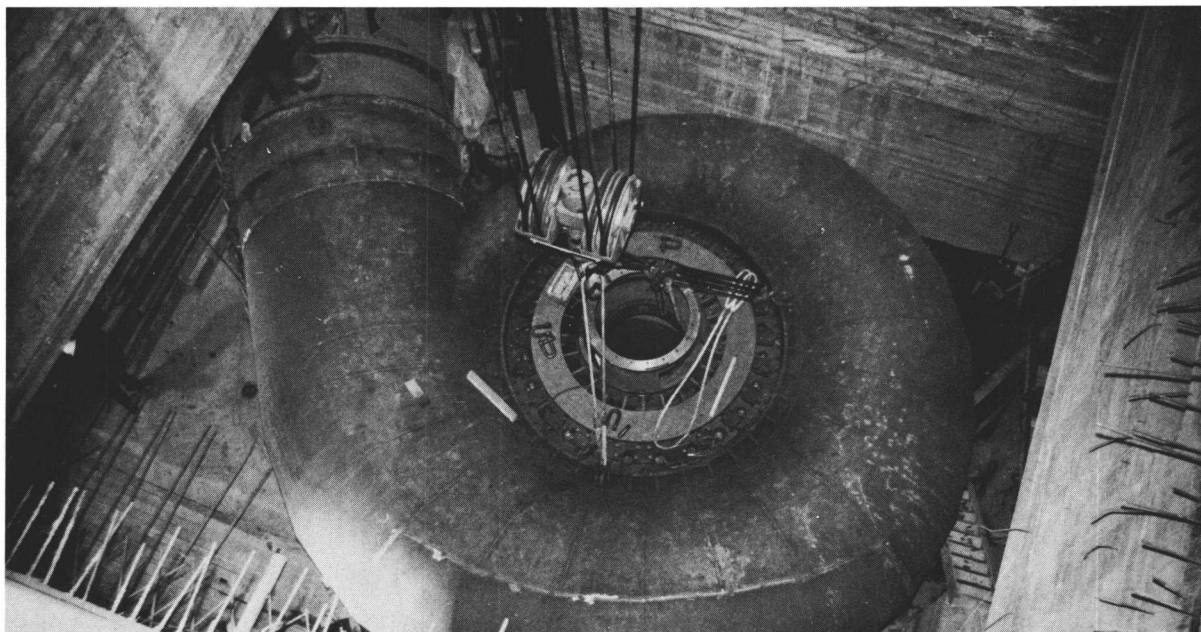
Gråsjo kraftstasjon, turbintromme.
