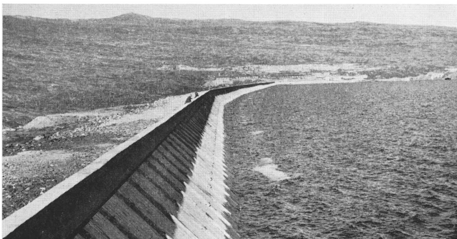
Fig. 24. Fra Aura-verkene. Aursjødammen ved forholdsvis lav vannstand. Høsten 1964 da magasinet var fullt, slo bølgene over damkronen og gravde ut massene på baksiden av dammen.
