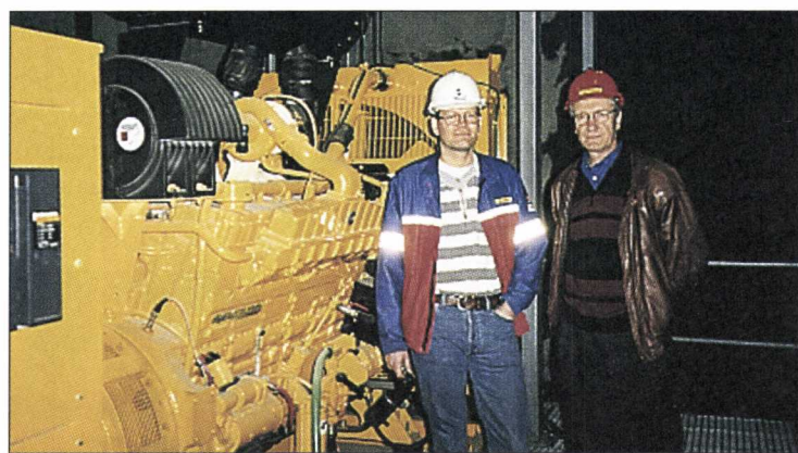
Per Erik Skattum viser stolt fram det relativt nye dieseldrevne nødstrømsaggregatet på 650 kV som er stort nok til å forsyne hele stasjonen. Hans Otnes fra NVEs sikkerhetsavdeling er fornøyd med oppgraderingen.
