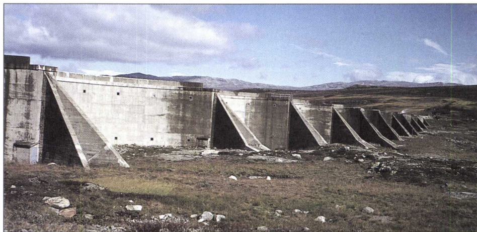
Stolvassdammen i Hallingdal har installert varslingsystem slik at beboerne langs vassdraget vil bli varslet ved dambrudd.
