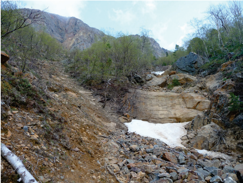
Figur 7 Skredrenner inne i dalen som fører ned mot bekken.
