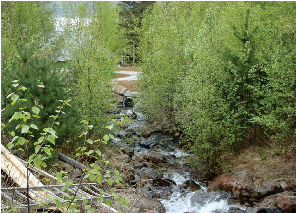
Figur 12 Bekken nedanfor voll og sedimentasjonsbasseng har liten plass og går delvis i dagen, delvis i rør. Eit nettinggjærde som er førd ned i bekken vil virke som ei fanggjærde for stein og drivgods.
