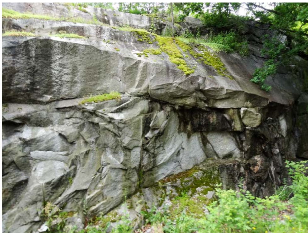
Figur 13. Potensielt ustabil skjæring som bør sikres med bolter.
