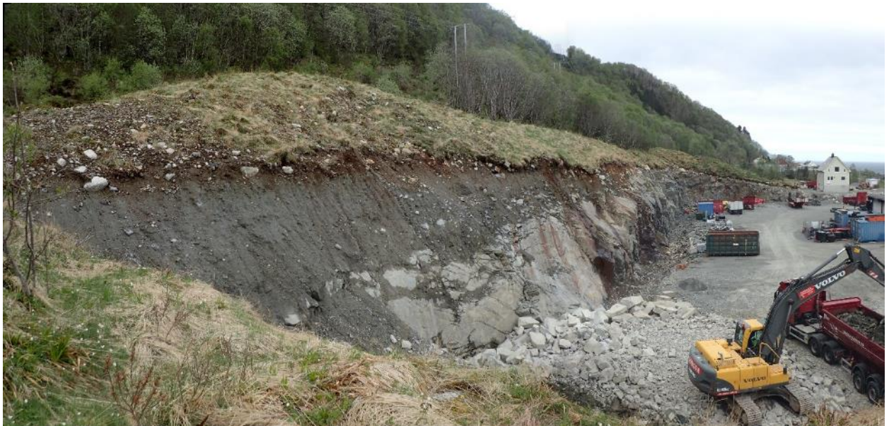
Figur 4: Byggegrøp under Lynghammeren. Løsmassevoll på toppen av skjæringa.
