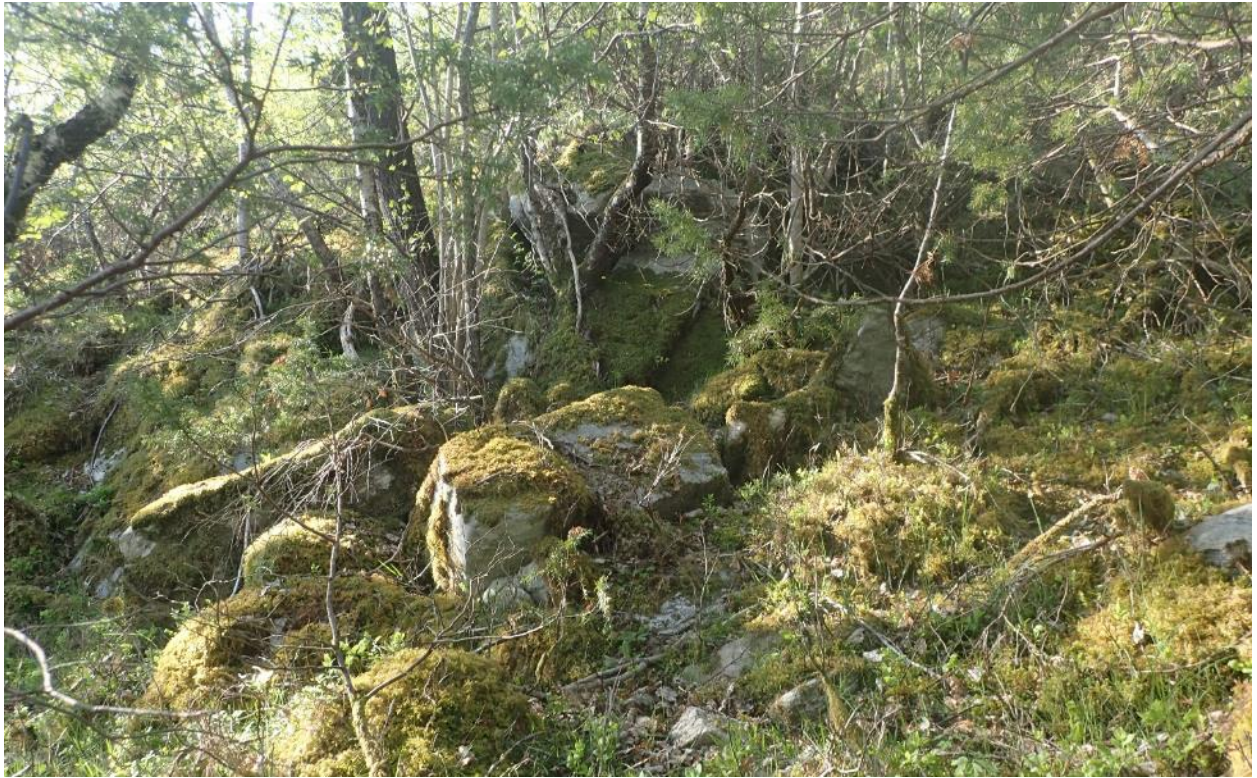
Figur 5 Lokale utfall fra mindre skrent øst for boligrekken i Uggedalen.
