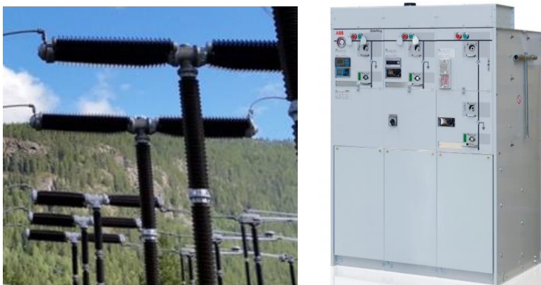
Figur 3 Høyspent (420 kV) effektbrytere (t.v) og ringkabelanlegg for 24 kV effekt- og lastskillebrytere (t.h.). Foto: NVE og ABB
