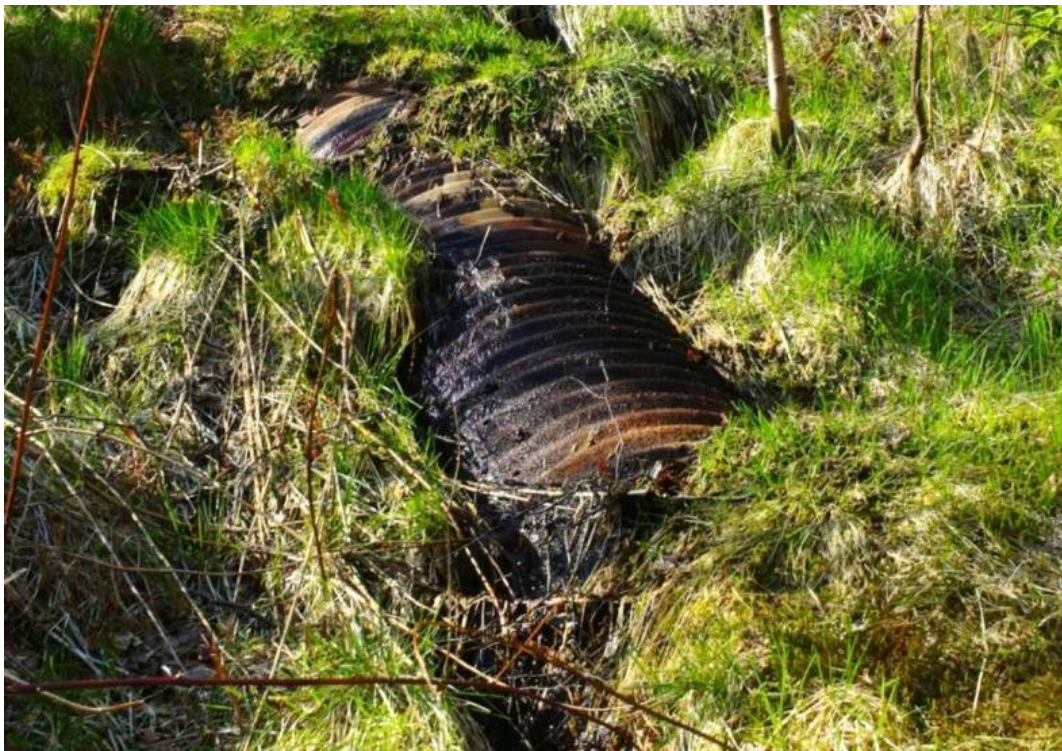
Fig. 6.5.1.10. Nedre del av røret gjennom Skårvegen boligfelt. Lekkasje på oversiden av røret kan tyde på blokkering lengre ned. Dette bør etterses! Foto: Terje H. Bargel.
