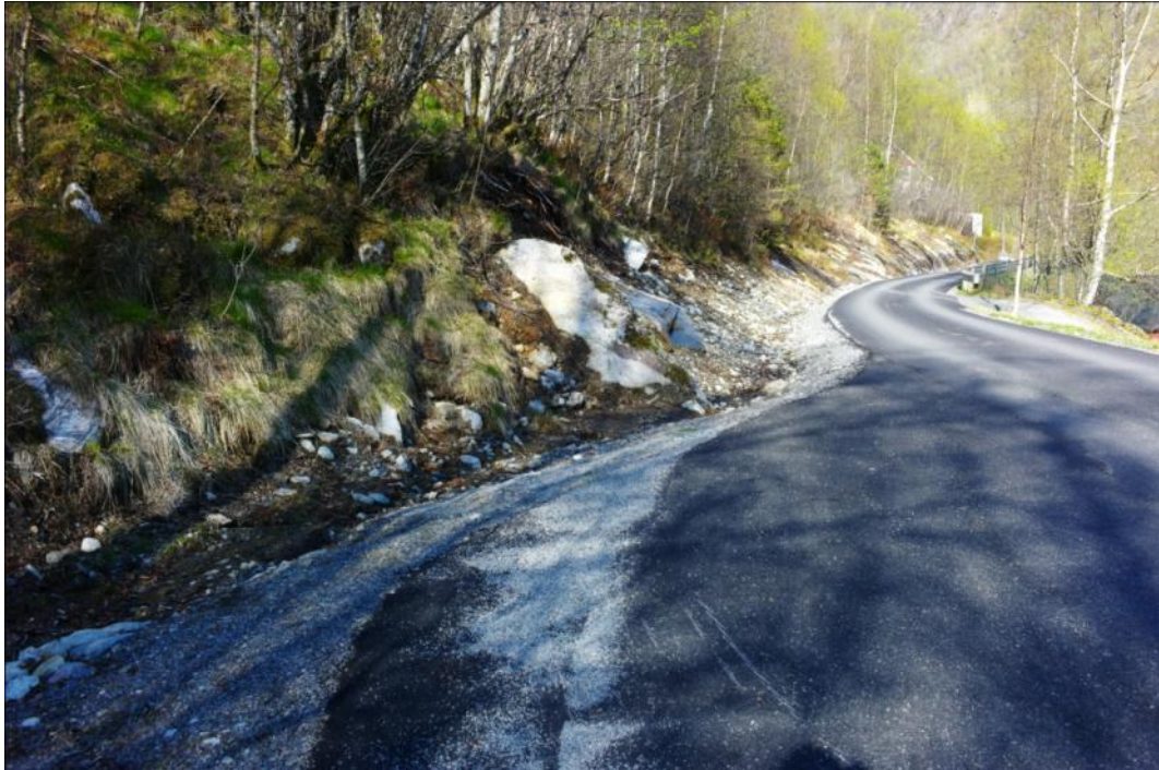
Fig. 6.5.1.9. Dreneringen langs oversiden av Skardsvegen sett fra rørinngangen på forrige foto. Foto: Terje H. Bargel.
