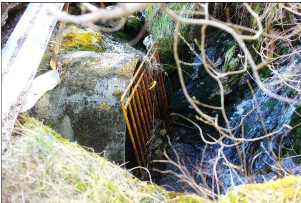
Fig. 6.5.1.7. Skardsbekken går i et grovt rør under Skardsvegen fra oversiden av boligfeltet. Innløpet her må holdes åpent til enhver tid! Foto: Terje H. Bargel.
