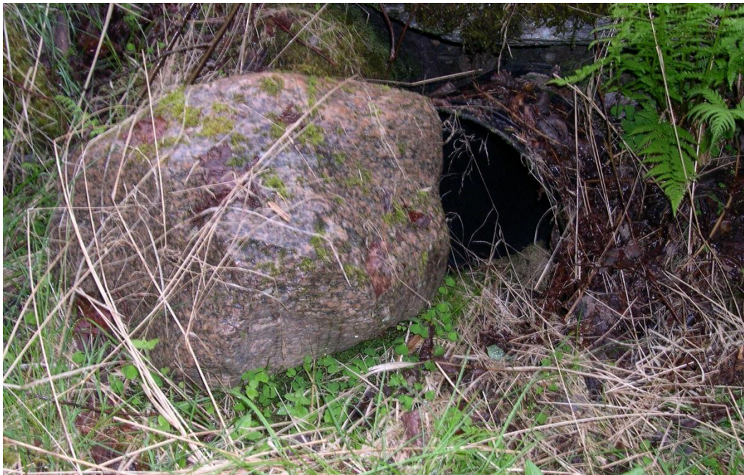
Fig. 8.5.1.6. En stein blokkerer inngangen til røret som fører bekken ved Bakkeskreda under skogsbilveien 150 moh.
