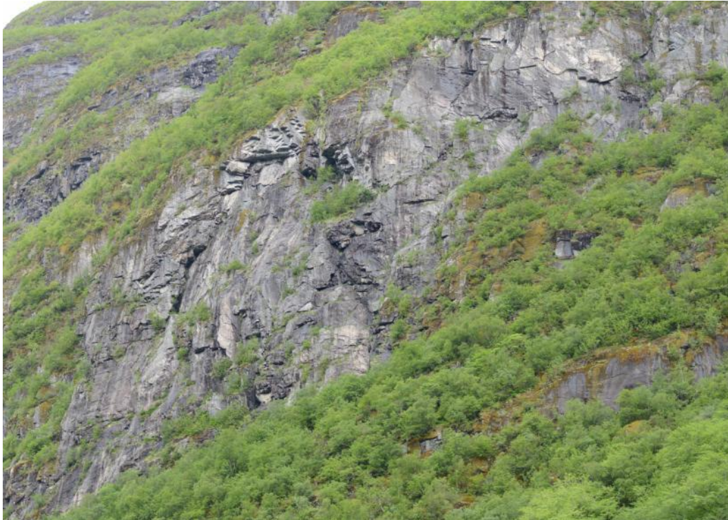
Fig. 4.4.1.1. Eksempel fra en bratt fjellvegg i Dale. Det er tydelig stedvis lysere farge på fjelloverflaten som kan kobles til kildeområder for nylig steinsprang. I tillegg er det observert blokker med overheng på øvre delen av fjellveggen.
