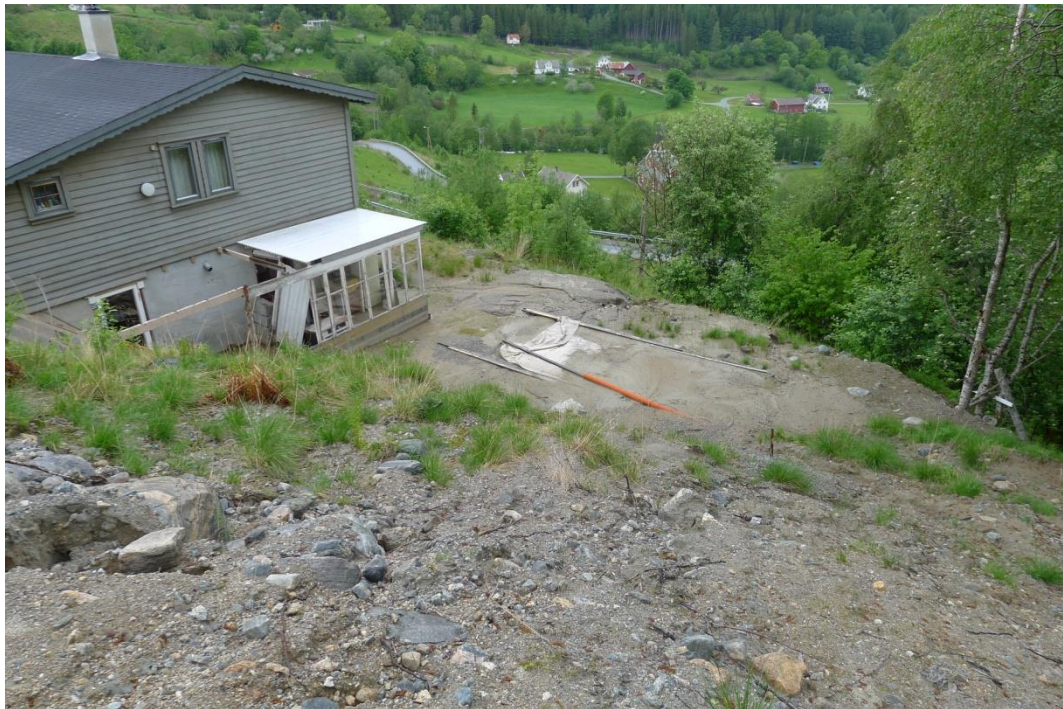
Fig. 9.5.1.1. Bekkeerosjon med materialtransport nært, og til dels inni sokkelen til et bolighus ved øvre hårnålsving på veien mot Brekke. Denne hendelsen skyldes menneskelig inngrep: Det var gravd en kanal fra bekkeløpet retning huset. Foto: Terje H. Bargel.
