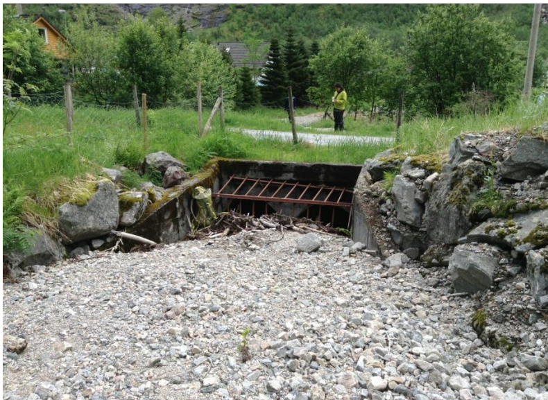
Fig. 4.5.1.3. Nederste del av flomskredløp på Daleviften, og den 2/3 igjenfylte risten ned mot veien. Risten var to dager etter første befaring rensket opp, men dette illustrerer likevel materialtransport og materialstørrelse i løpet.
