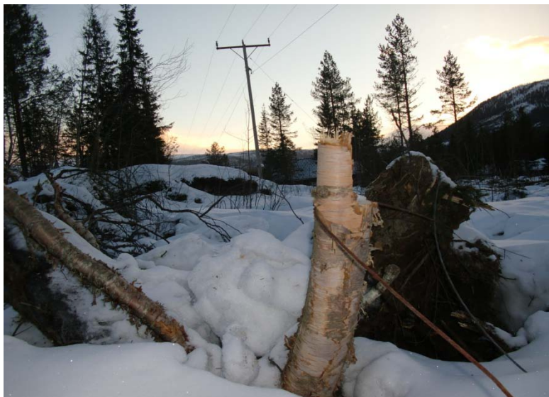
Bilde 3: Kraftledning som ble ødelagt under Hilde utenfor tettstedet Namskogan i Nord-Trøndelag. Foto: NVE.
