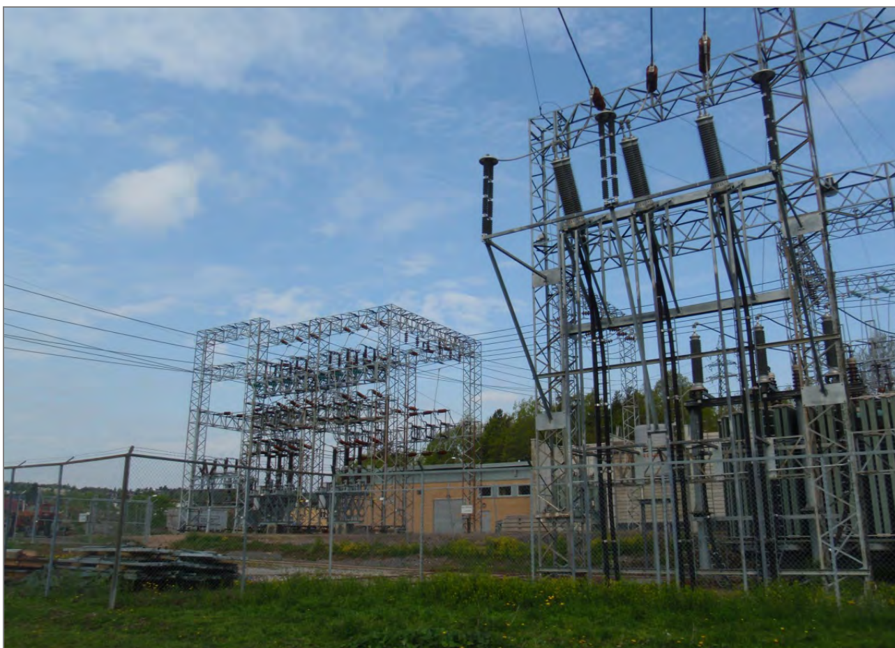
Bryterfeltet på Abildsø transformatorstasjon har stor skala.
