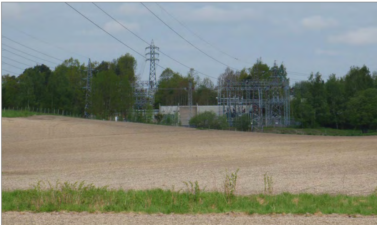
Dagens situasjon ved Abildsø transformatorstasjon sett fra friluftsområdet ved Østensjøvannet.
