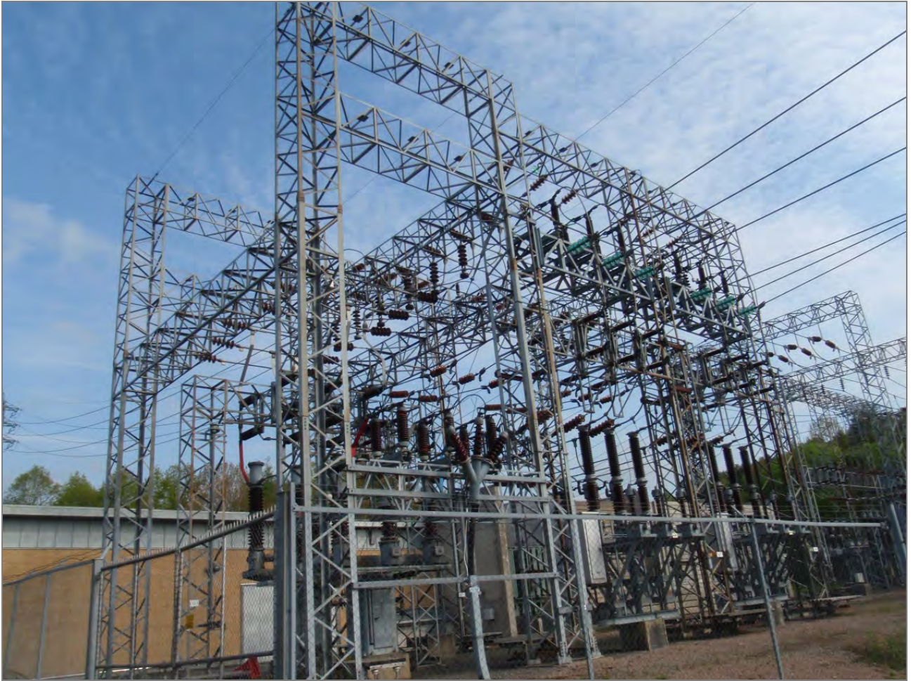
Koblingsanlegget på Abildsø transformatorstasjon er ruvende.
