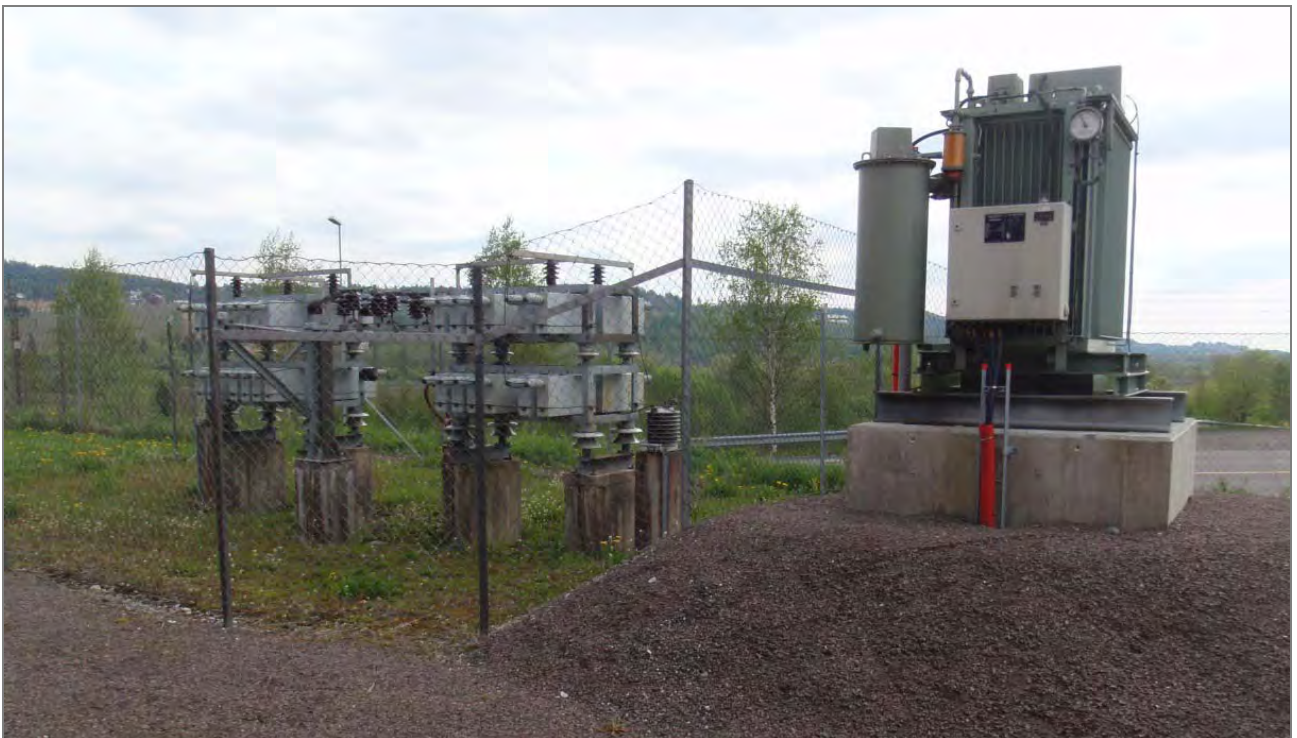
Utendørs kondensatorbatteri er plassert i utkanten av anlegget. Kondensatorbatteriet til venstre, Peterson-spole til høyre.
