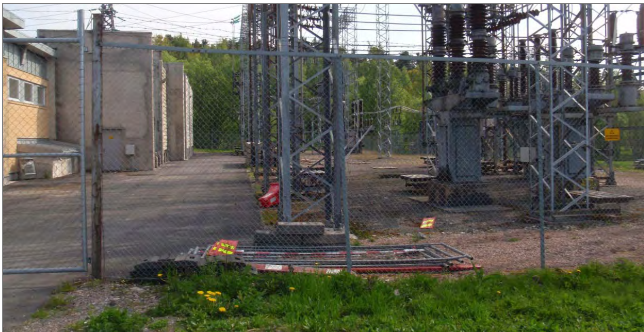
Visuell uorden innenfor gjerdet.
