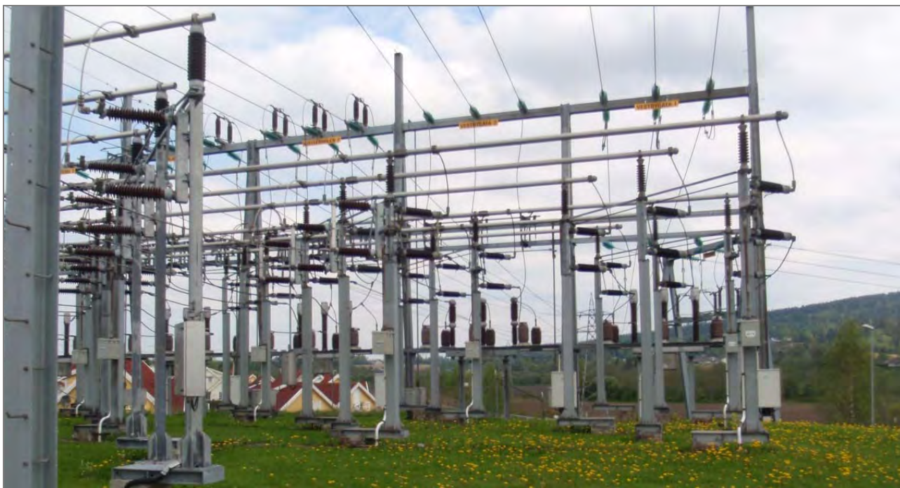
Koblingsanlegget på Leirsund transformatorstasjon er ryddig og har gressdekke som gir et grønt preg.
