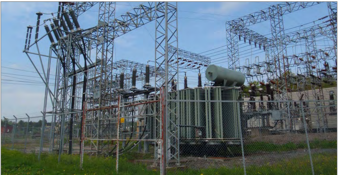
Utendørs transformator øker kompleksiteten i utendørsanlegget.
