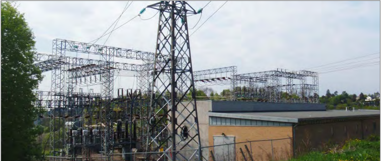
Abildsø transformatorstasjon sett fra Plogveien.
