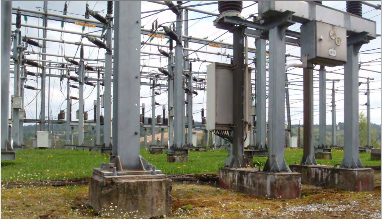
Leirsund transformatorstasjon har kompakt og ryddig bryterfelt.
