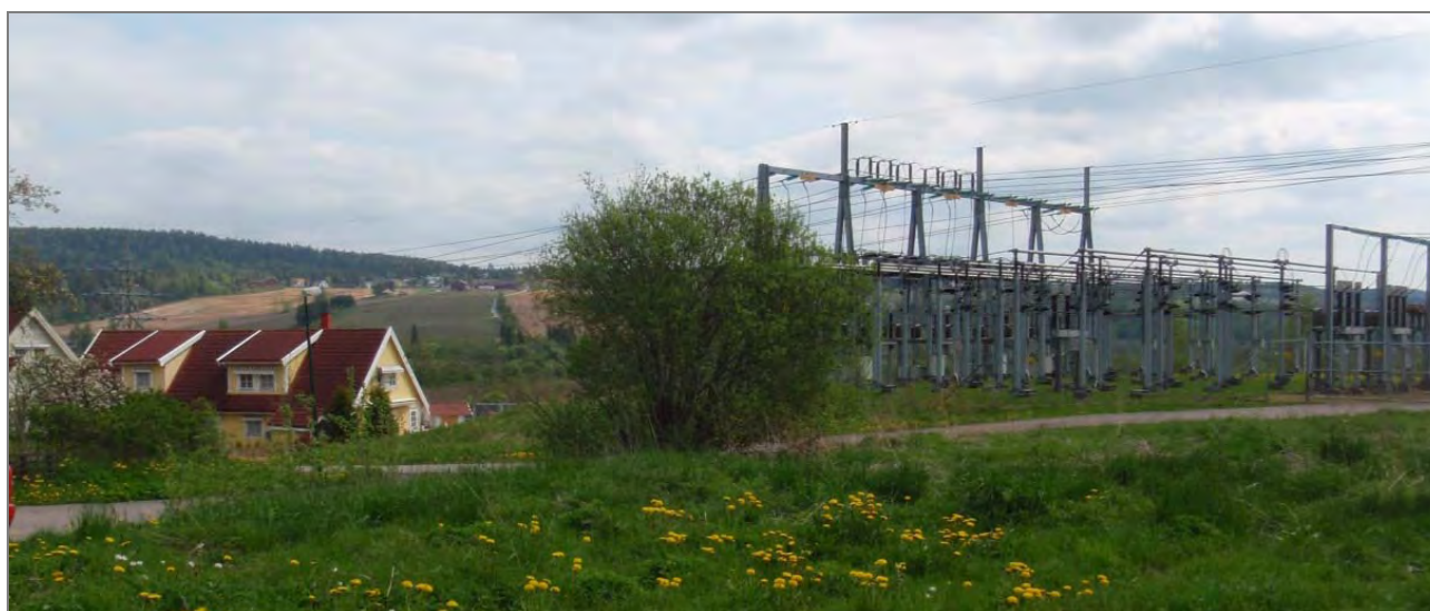
Leirsund transformatorstasjon sett fra gangvei i vest.
