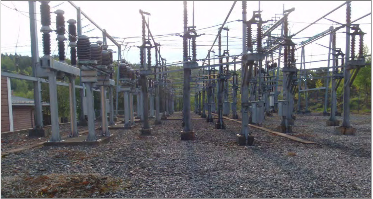
Koblingsanlegget på Tårnlia transformatorstasjon.
